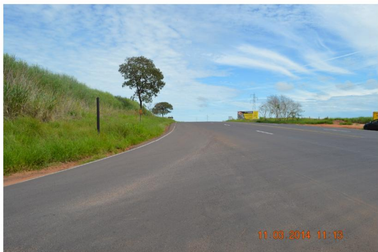
Foto nº 12 – vista da faixa de desaceleração do acesso ao Bairro Salgado Filho, sentido Junqueirópolis a Irapuru.
